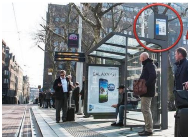
Figuur 27 Small cell antenne-installatie in een tramhalte [57]
